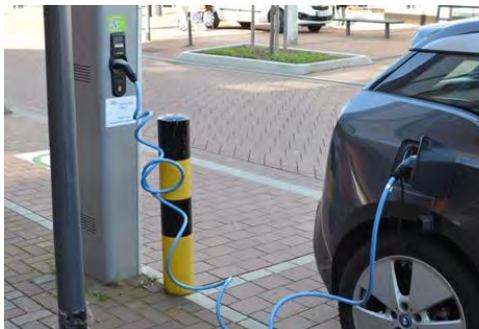
Abb. 4.6-1 E-Ladesäule während des Ladevorgangs 15
